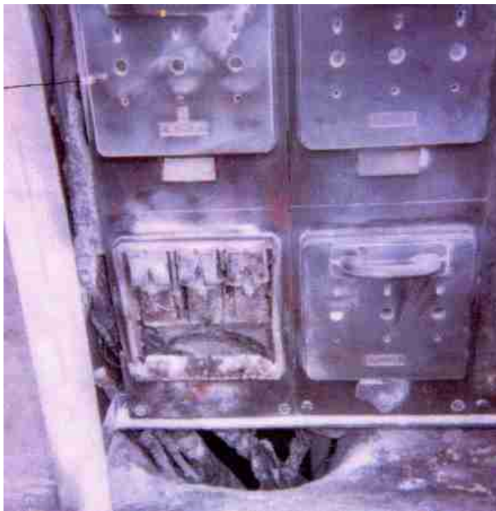
Bild: Ausgebrannte 20 kV-Station nach dem Kurzschluss
